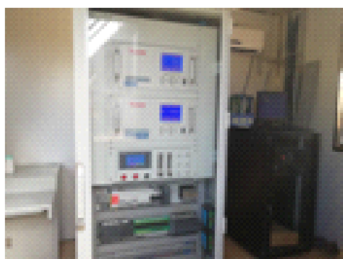
废气在线监测系统
